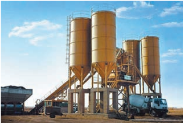
රූපය 1.128 පෙර මිශ්‍රක බලාගාරය (Pre - mix Plant / Batching Plant)
